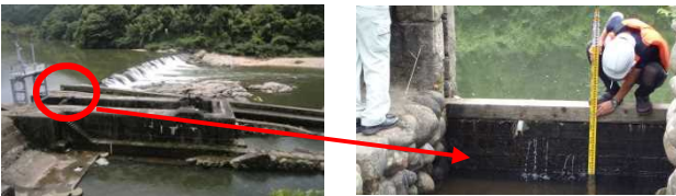
写真-4 相楽発電所取水堰魚道の課題箇所(落差)
