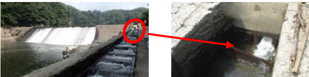
写真-5 大河原発電所取水堰魚道の課題箇所(潜孔部)
