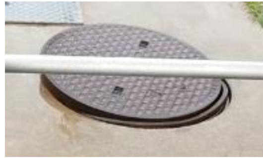
図-3 マンホールの脱落
