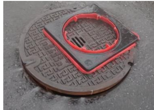
図-4 マンホールの浮上
