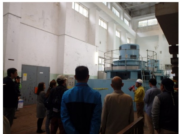
写真-4 発電機見学状況(中島発電所)
