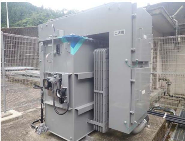
写真2 ダミー負荷設備（布目ダム管理所）
