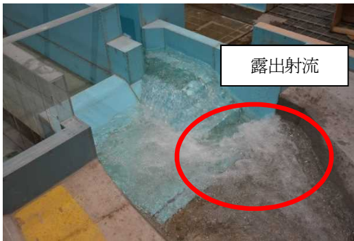
図-16 河床部放流設備・常用開水路の流況
