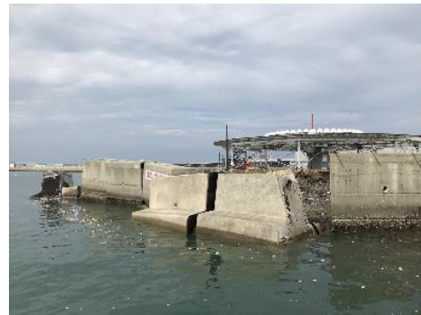
図-4 VOR/DME部被害状況
