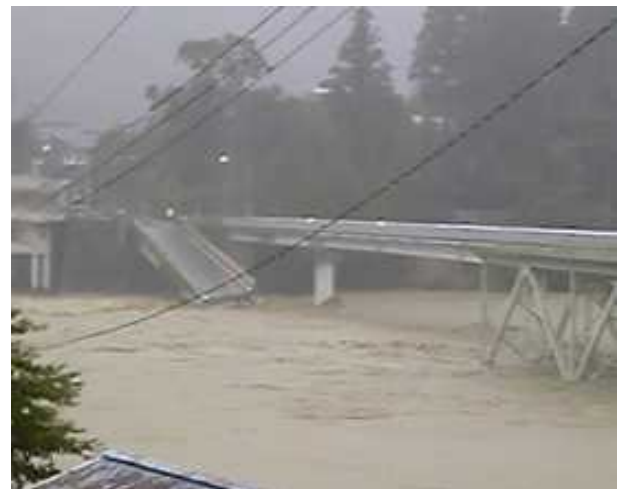
写真-7 国道168号折立橋が落橋
