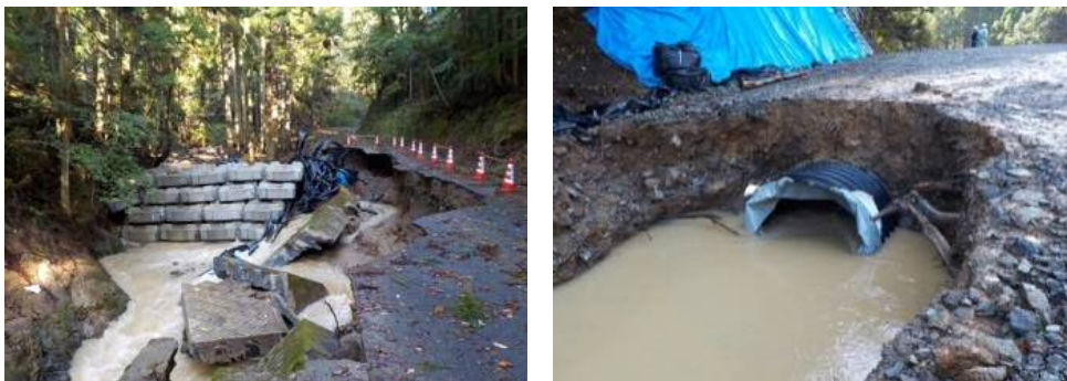
図-15 台風24号の被災状況
