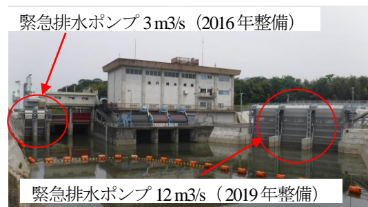
図-9 法川排水機場
