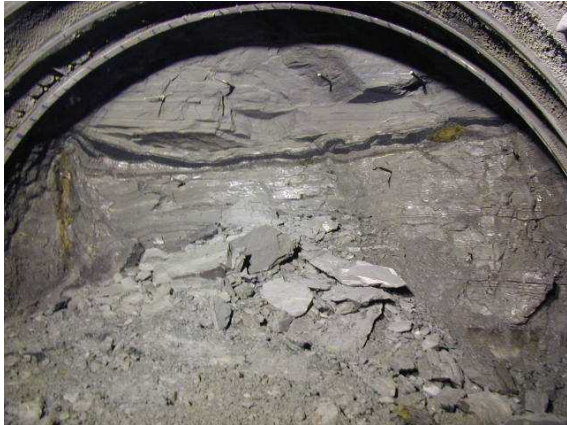
写真-1 切羽崩壊の例（天端崩落）
