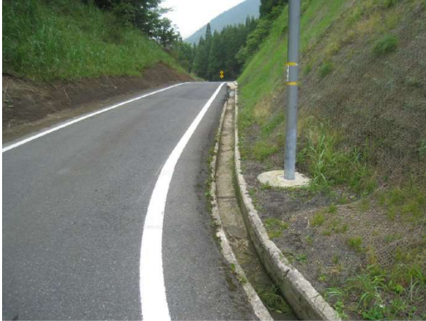
写真-7 脱輪の恐れのある側溝
