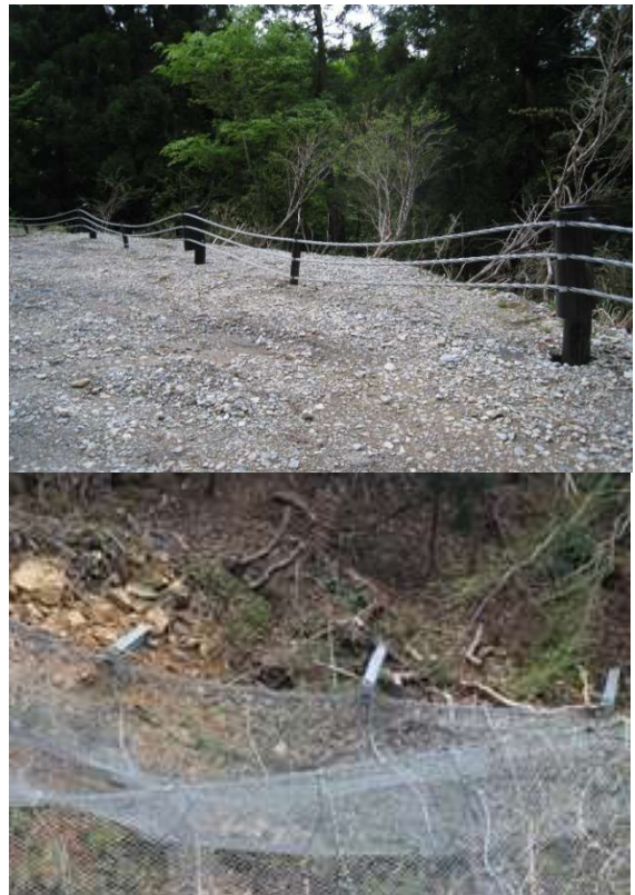
写真-2, 3 落石防止網・防護柵の被災状況
