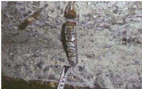
写真-4 P16 スターラップ破断状況
