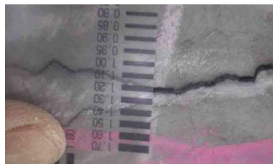
写真-2 主桁ウェブひび割れ状況(最大幅 1.2mm)
