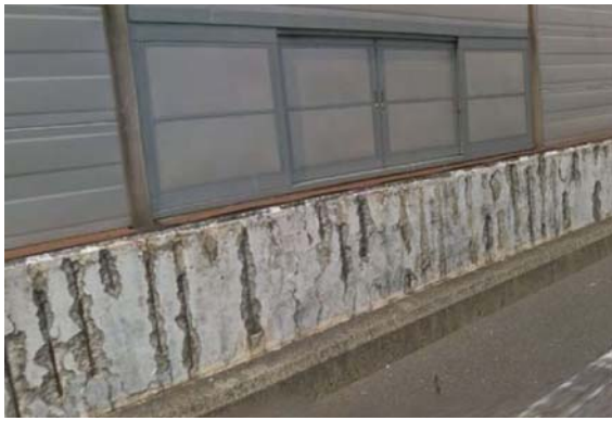
写真-3 壁高欄損傷状況
