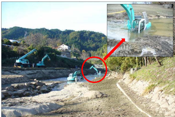
写真-1 平成 18 年度堆砂除去工事での事故状況
