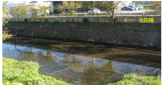
写真-2 高谷川仮設水防柵
