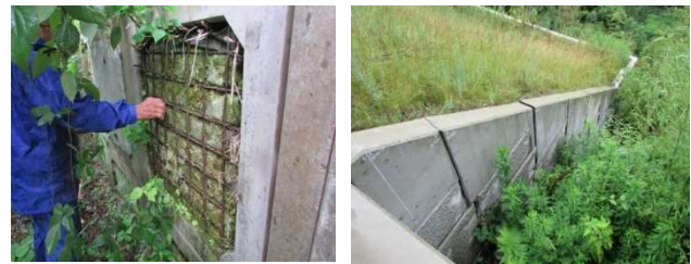
図5 補強土壁の変状（左：損傷 右：開き）
