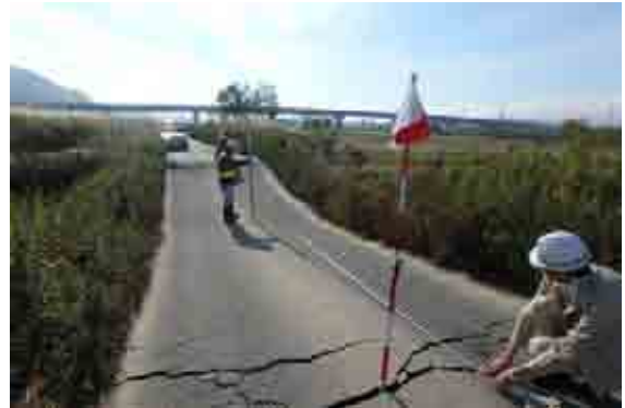
写真-7 工事用道路の陥没
