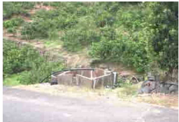
水槽及び配管
