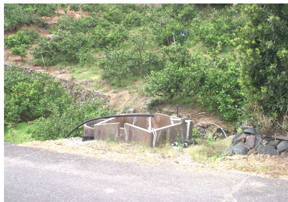
水槽及び配管
