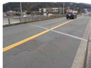
写真 1 舗装損傷状況
