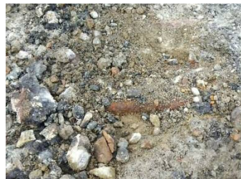
写真3 床版土砂化状況
