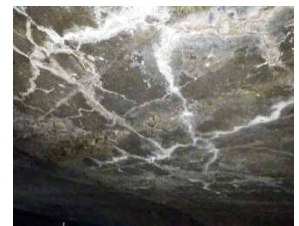
写真 2 床版下面状況
