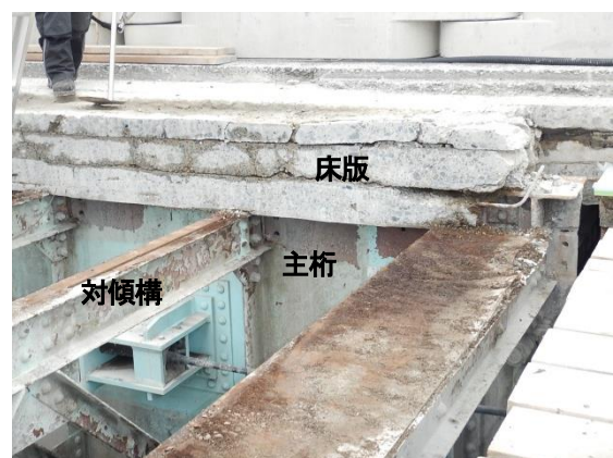
写真-3 主桁上フランジが床版の中に埋まっている
