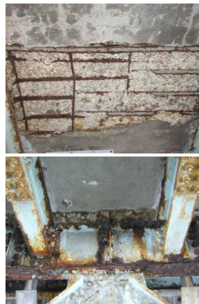
写真-1 床版や橋桁の損傷状況
