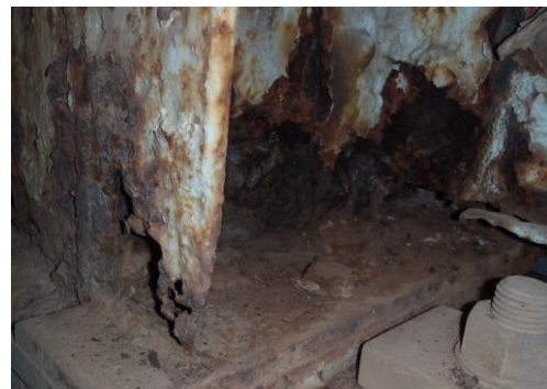
写真-6 腐食による孔食状況
