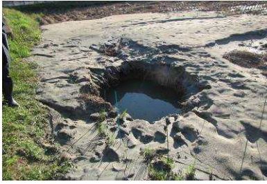
写真6 漏水後の陥没状況 (R5地点)
