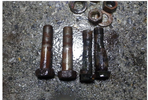
図-7 ボルト状況写真(左：健全2本 右：撤去後2本)
