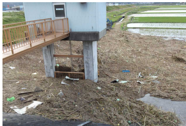
写真-1 遊水地内ゴミ堆積状況(小田)
