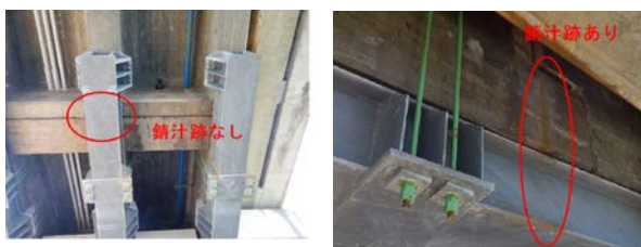
写真-9 桁下の漏水状況
