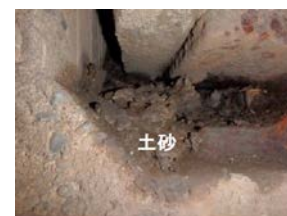
【土砂堆積状況】
