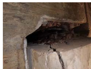
【再劣化したひびわれ】
