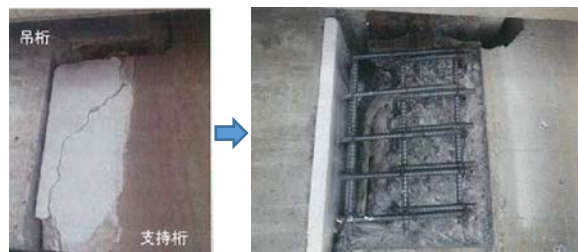
【ポリマー系断面修復後のひびわれ】
