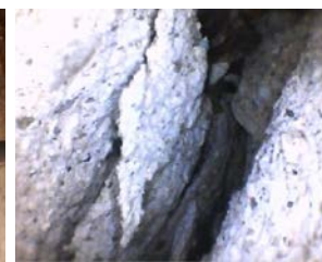
【ひびわれ内部状況】
