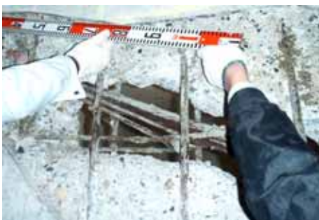
図4 P17-18径間G2桁はつり部
