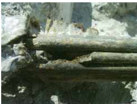
図-10 上縁定着部の劣化状況
