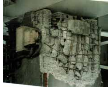
図-17 P463 山側柱の破壊(北面) 13)
