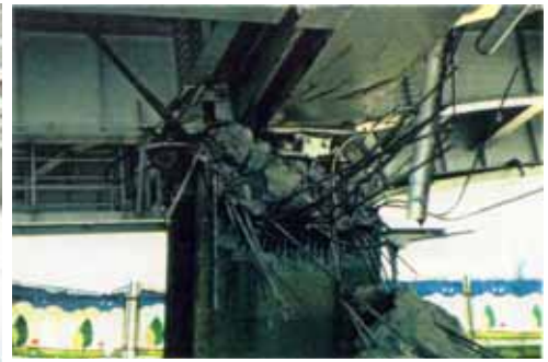
図-16 P458 海)柱の破壊状態(北面) 18) (支承のセットボルトが残存)
