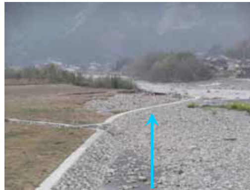
写真-4 低水護岸突出部が洗掘された状況
