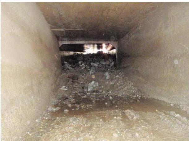
図-5 既存道路横断ボックスカルバート閉塞状況
