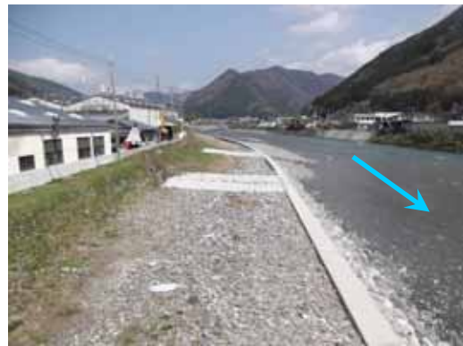
写真-6 2011年出水被災後全景
