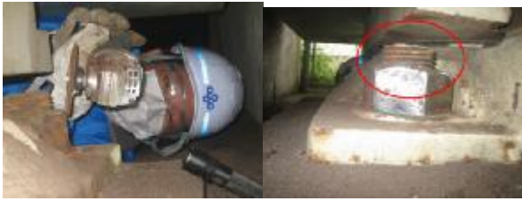
(写真-4) 動力工具ケレン：ボルト部の残存錆
