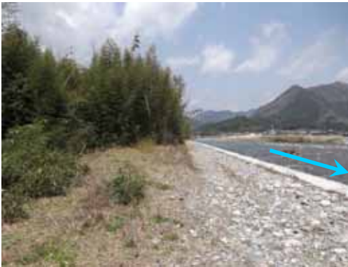
写真-9 竹林背後地が洗掘されていない。
