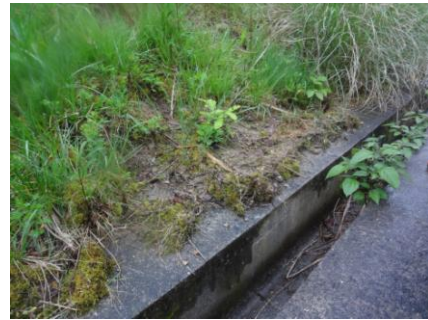
写真-1 盛土小段の堤内からの浸出状況例
