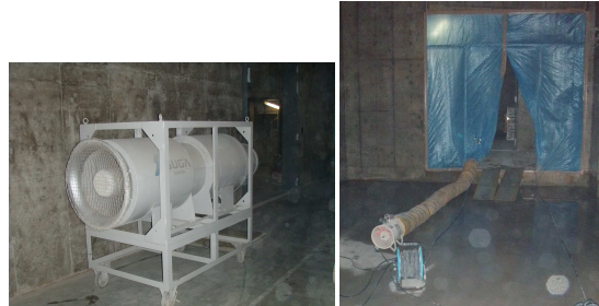
写真-5 換気除湿運転状況 (送風機)
