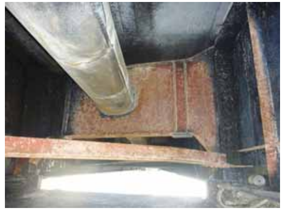
図-3 下横桁の変形部分
