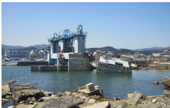
図-1 東日本大震災における被災状況
