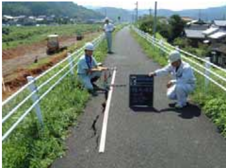
写真-3 施工に伴う法肩付近のクラック
