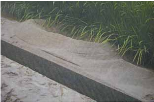
写真-2 噴砂状況 (貴志川左岸1.7k付近)
