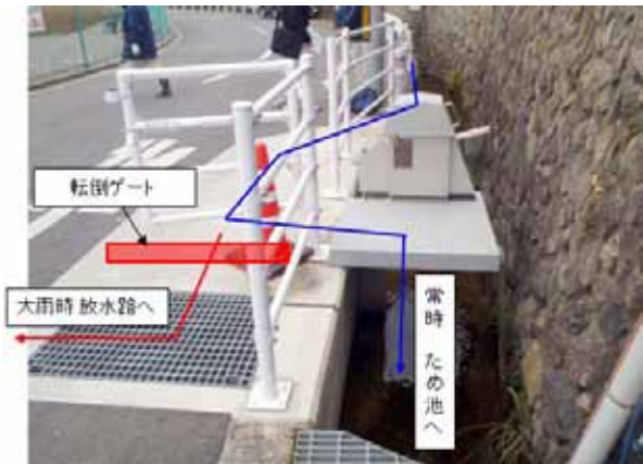
写真-1 自動転倒ゲート
