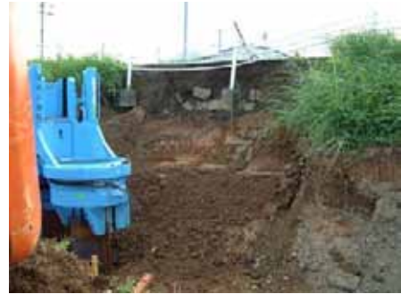
写真-2 堤防法面崩壊状況
