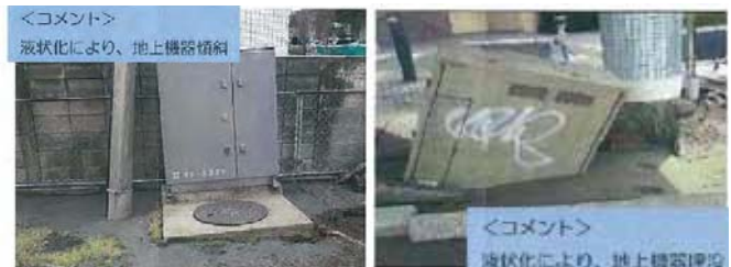
図-1 地上機器の被災状況 2)
