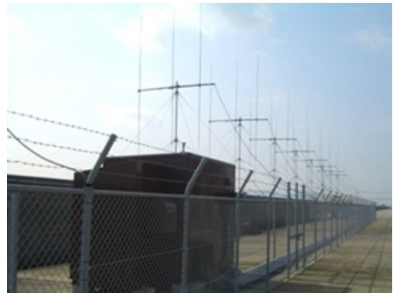
図-4 海洋レーダの外観(垂水局)
