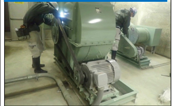
換気ファンベルト劣化点検
