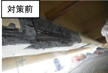
主桁鉄筋の腐食
