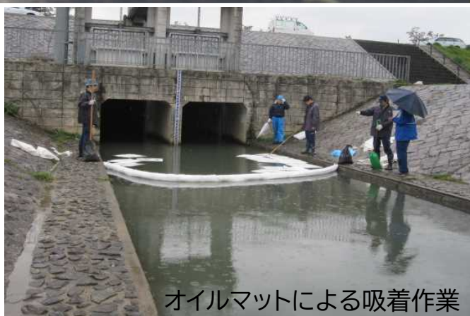
吸着式オイルフェンスの設置例
