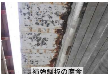
補強鋼板の腐食
