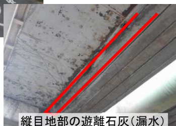
縦目地部の遊離石灰(漏水)
