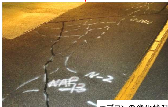
エプロンの劣化状況
