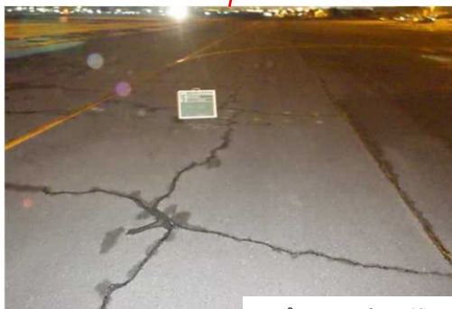
エプロンの劣化状況
