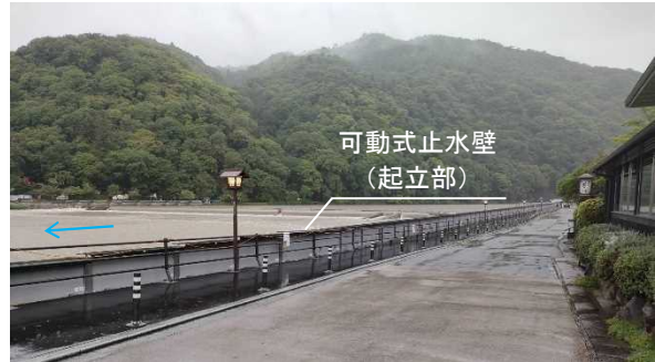
可動式止水壁の実動状況
