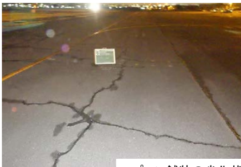
エプロン舗装の劣化状況
