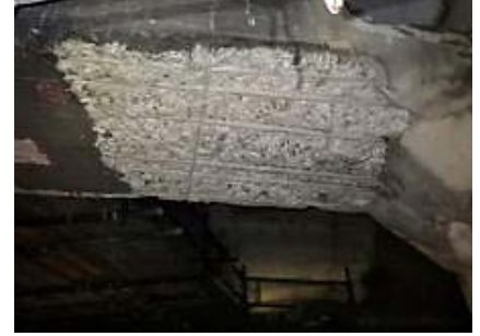
【下部工の断面欠損】
