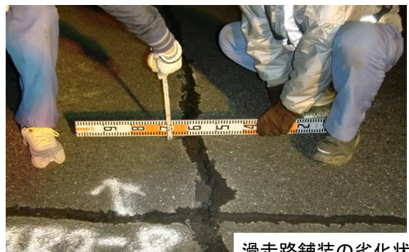
滑走路舗装の劣化状況
