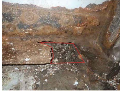
【鋼材部の断面欠損】
