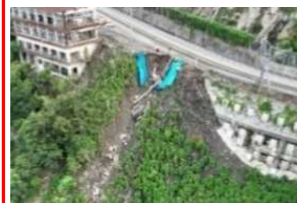
国道8号 被災状況
