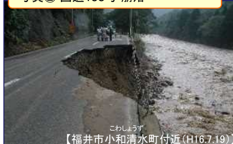
写真② 国道158号 崩落
