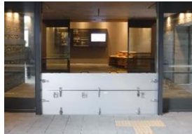
▲防潮板を使用した様子
