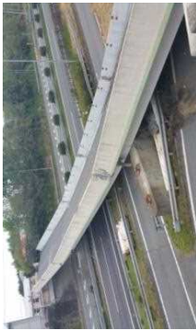
九州自動車道をまたぐ跨道橋の落橋 （県道小川嘉島線・府領第一橋）
