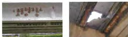
コンクリートの保護塗装後に剝離した例 鋼板接着により補強されたコンクリート床版が抜け落ちた例
