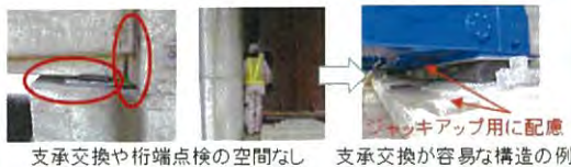
支承交換や桁端点検の空間なし 支承交換が容易な構造の例
