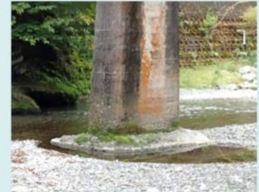
洗掘された橋脚
