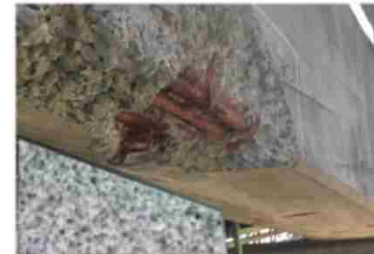
損傷状況(鉄筋露出)
