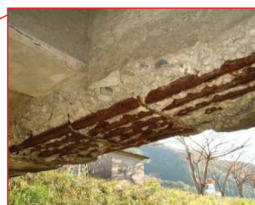
主桁の剥離、鉄筋露出
