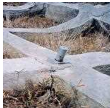
写真 受圧構造物の破損の例
