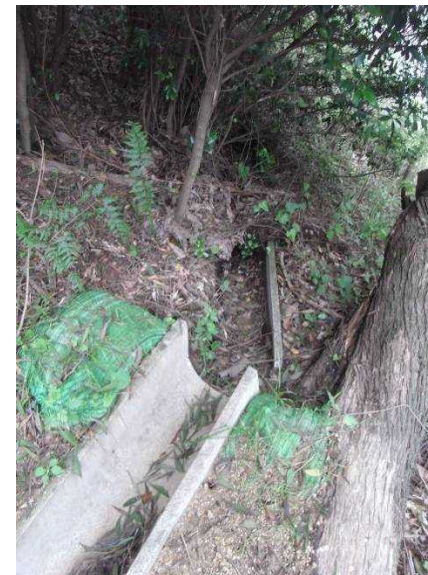
写真 排水溝の破損の例
