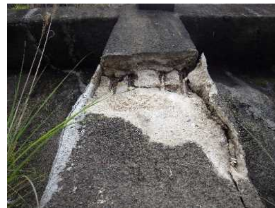
法砕工の老朽化損傷
