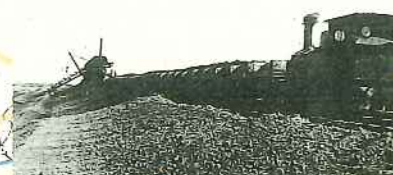
淀川の改修増補工事で、1920年(大正9年)に初め て導入された20トン機関車と掘削機 (枚方市踏踏地先・1922年(大正11年) (郷土出版社刊「枚方・交野の100年」より)
