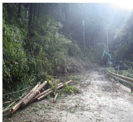
▲堺かつらぎ線(和泉市善正町)で発生した法面崩壊の状況
