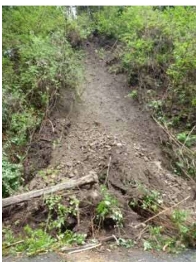
▲国道480号の法面崩壊状況(H27.4.21)
