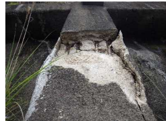
法砕工の老朽化損傷
