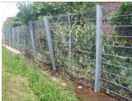
写真 落石防護柵の傾動の例
