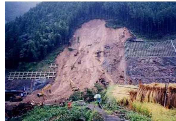
強風化・土砂化斜面での崩壊例
