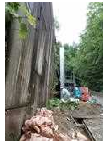
写真 壁面の傾斜の例
