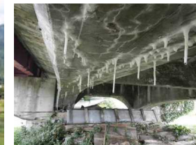
主桁のひびわれ
