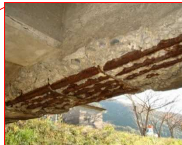
主桁の剥離、鉄筋露出
