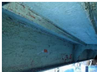
桁の塗装劣化やさびの発生
