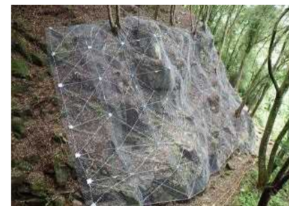
落石防護ネット
