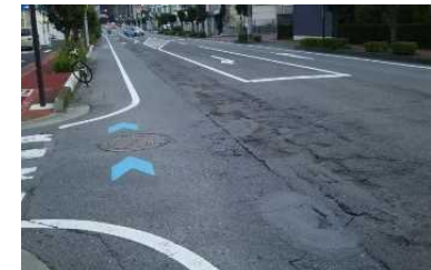
占用工事が起因する路面損傷
