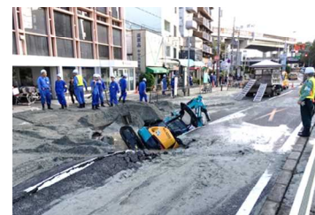
埋設管の老朽化に伴う道路陥没
