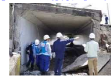
熊本地震における地方公共団体管理施設の被害状況調査
