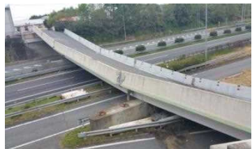
ロッキング橋脚を有する橋の落橋
