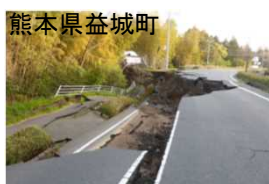
熊本県益城町 盛土の崩壊
