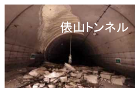
俵山トンネル 覆工コンクリートの崩壊
