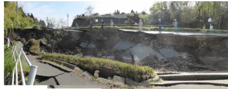
路面陥没地付近の状況（4月15日）
