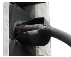
ケーブル損傷例
