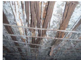
PC鋼材の腐食例
