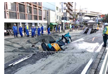
埋設管の老朽化に伴う道路陥没
