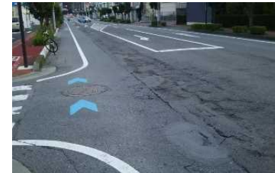
占用工事が起因する路面損傷
